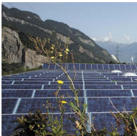
Solaranlage auf dem Hallendach der Josias Gasser Baumaterialien AG in Chur
